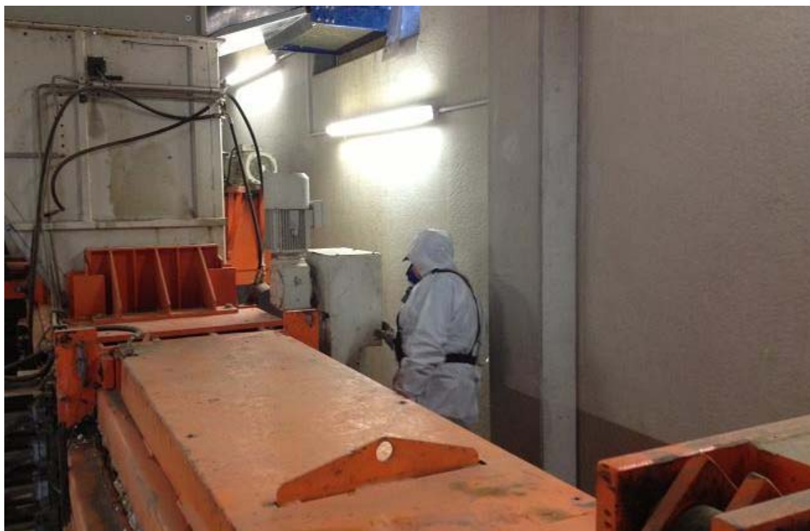
Bild 5: Überwachung der Anlage während des Pressvorgangs (Nr. 5, 7, 15)
