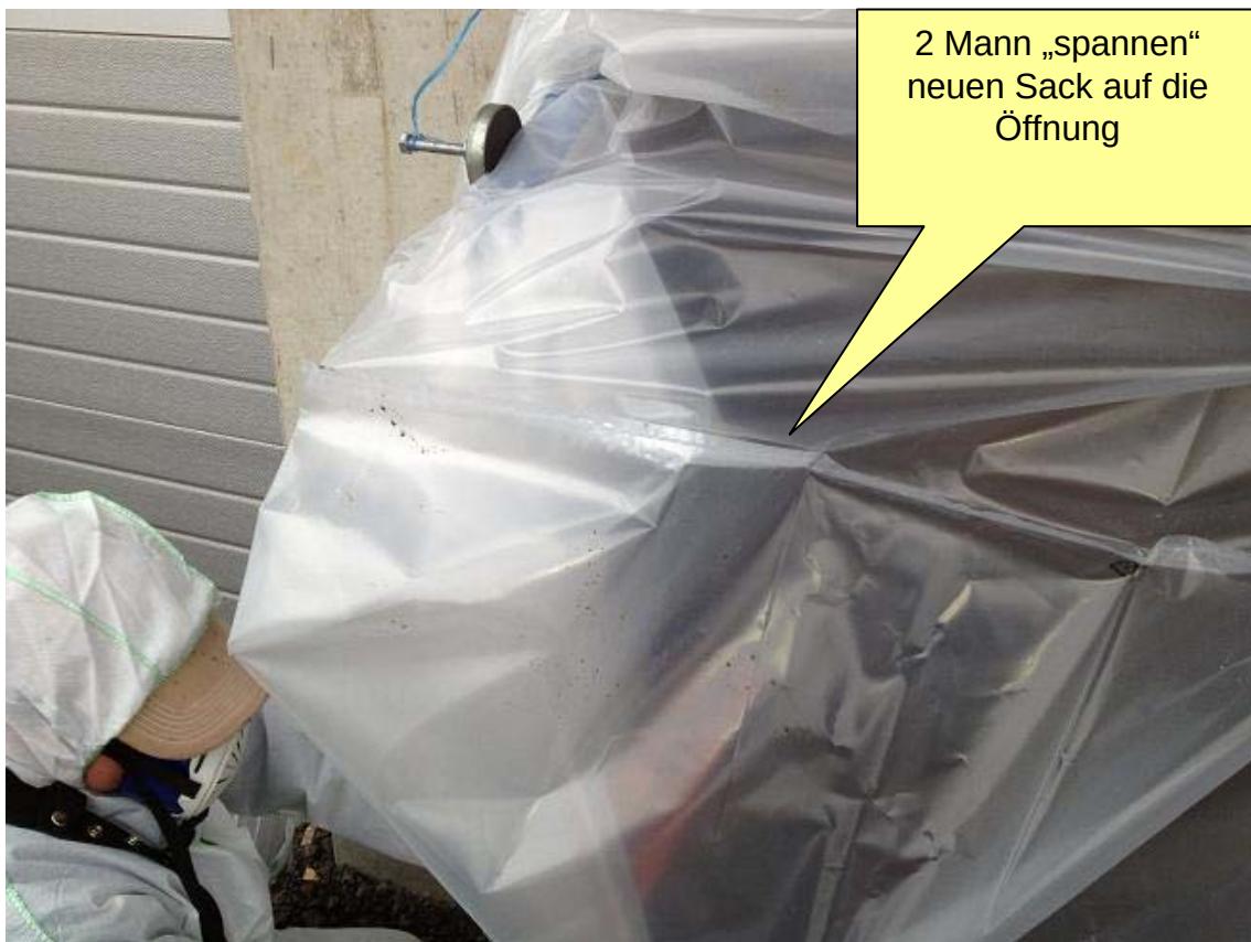
Bild 8: Neuer Sack an Ausgangsführung angebracht (Nr. 9, 13, 17)
