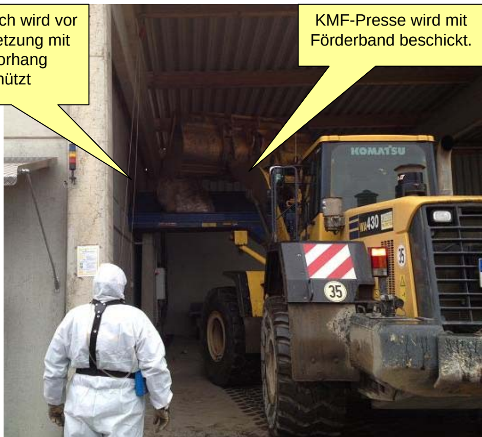
Bild 3: Überwachung der Beladung des Förderbandes (Nr. 3)
