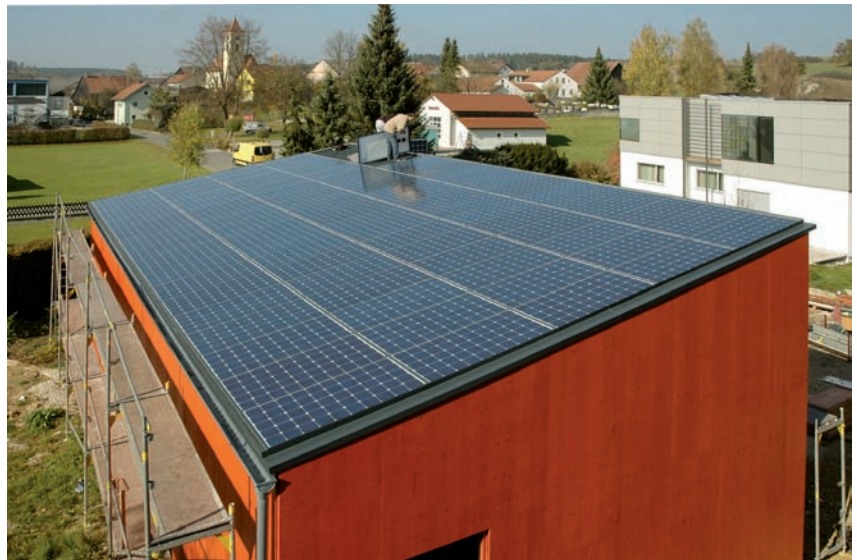
Nebengebäude, ob privat, gewerblich oder landwirtschaftlich, bieten hervorragende Dächer für große vollflächige Anlagen. Bei diesem Beispiel in Denkendorf im Lkr. Eichstätt wurde besonderer Wert auf ein filigranes Dachprofil gelegt (Planung und Foto: Thomas Sendtner)
