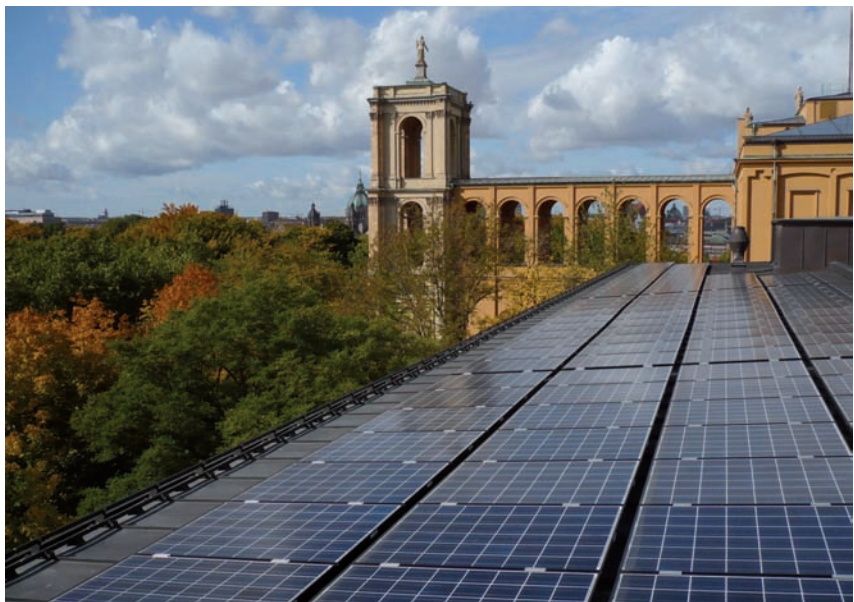
Ein Bürgersolkraftwerk auf dem Dach des Maximilianeums in München. Die in unmittelbarer Nähe des denkmalgeschützten Altbaus gelegene Anlage ist von der Straße aus nicht einsehbar (Foto: Achim Schröer)
